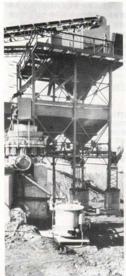
圖為安裝在美國田納西州Green Brier 破碎場帶有成套潤滑設備的48" 旋盤式破碎機，6' × 16' 雙層 Nordberg GP 篩和 Nordberg 皮帶運輸機。
